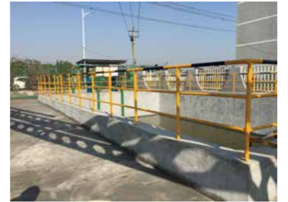
单身楼生活废水收集井
