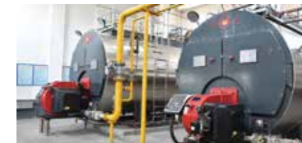
新建 19 蒸吨/小时燃气锅炉
