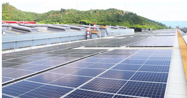
▲ 广东新兴光伏发电系统
